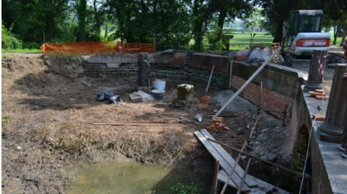
Canale della Corsa, Darsena Meridionale: l'attracco delle barche durante le lavorazioni di consolidamento.
