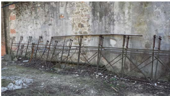
Canale delle Pavoniere, secondo ingresso al Parco: parapetto dell'attraversamento in ferro appena recuperato e prima del restauro.
