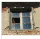
infissi in legno
