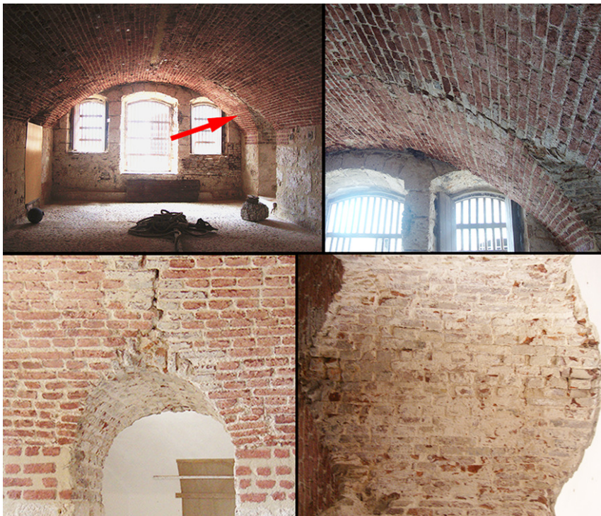
Figura 3. Le lesioni (la n.3 nella volta n.2) che sono oggetto di studio e la conformazione del falso arco.
