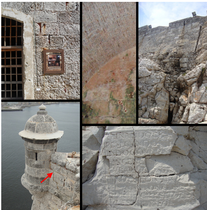
Fig. 1 Alcune attuali casistiche di degrado (in alto da sinistra): erosione dell'intonaco e della pietra, umidità negli spazi all'interno, la fessura della base rocciosa, le lesioni nel parapetto di attacco alla struttura della garitta ed infine l'erosione che danneggia l'antica iscrizione in pietra.
