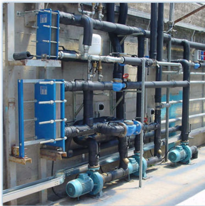
Figura 38: Circuito di dissipazione a doppio loop
