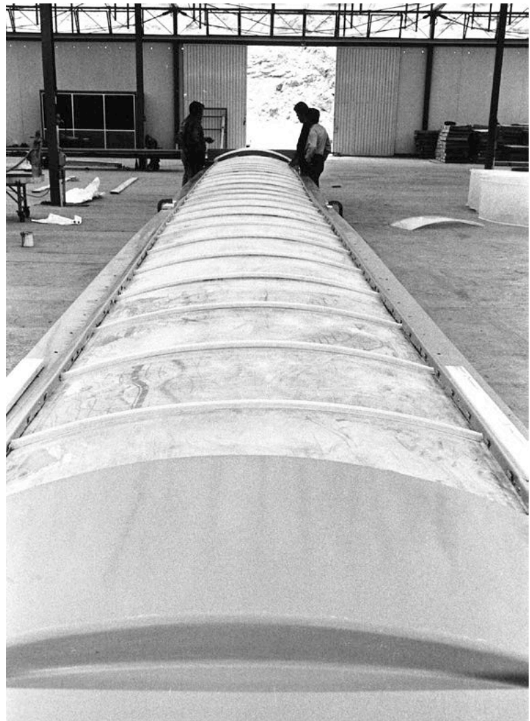
prova della posa e dell'assemblaggio dei telai di polimetilmetacrilato all'interno dell'officina dell'Impresa Piano Ermanno.
