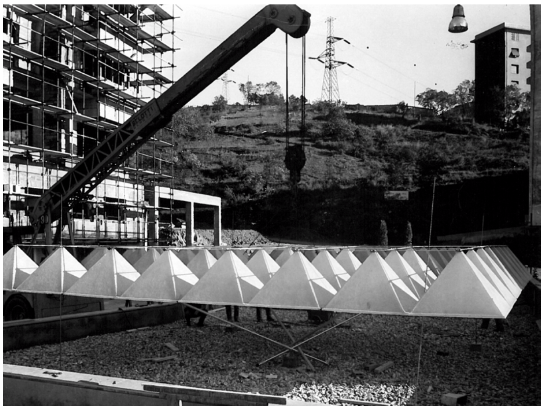
Fig. 82 - Renzo Piano, Struttura di copertura in elementi piramidali di poliestere rinforzato, Erzelli (GE), 1965. (FRP)
