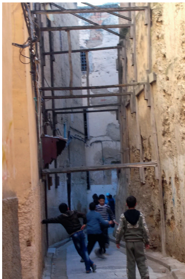
Fig. 15 – Strada della Medina con edifici pericolanti. Fonte: fotografia di Zineb.
