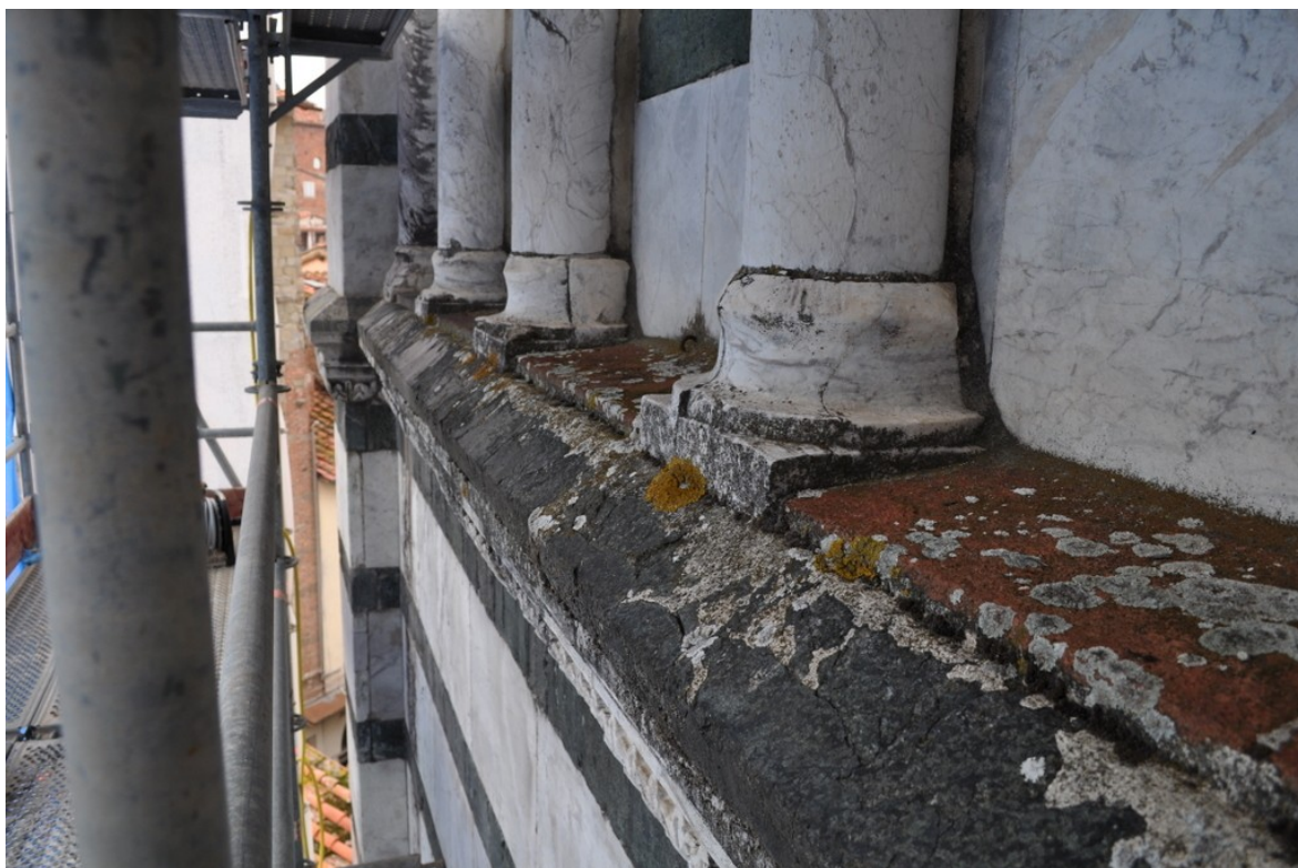
Fig.1. 37: Degrado anno 2018 Livello archeggiature, lato Sud-Est
