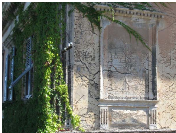
Fig.1. 9: Imperia, intonaci degradati su villino primo Novecento.
