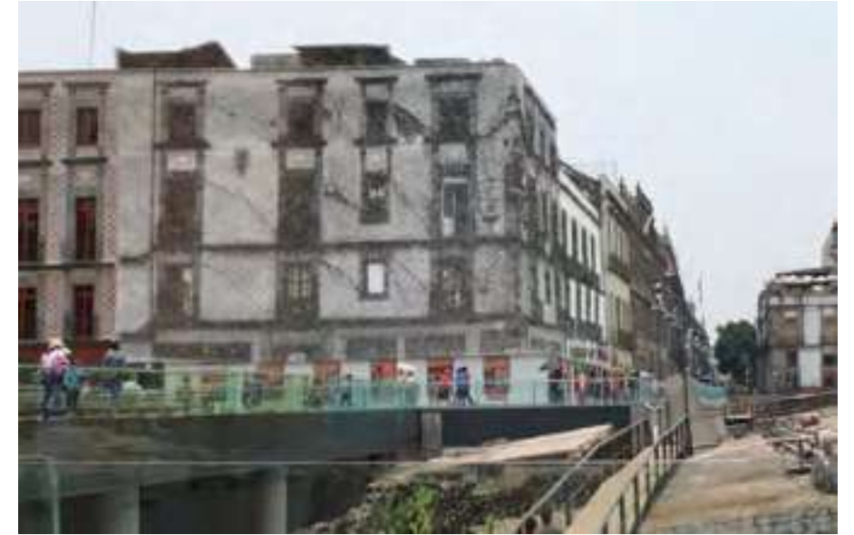
Fig.53 - Reconstitución digital de la fachada norte de la Casa de las Ajaracas, fotografía base de 1991, donde es evidente el daño existente en el inmueble, delatado por la cantidad de grietas en fachada y hundimientos diferenciales. Técnica usada Photoshop.
