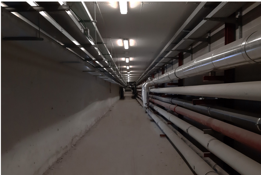
Figura 04.53. Un tratto di una porzione di cunicolo che ospita il passaggio impiantistico.
