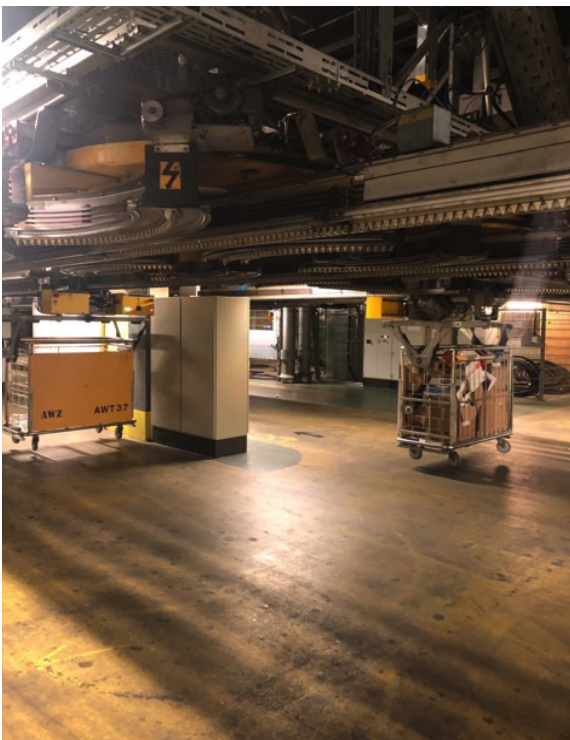
Figure 04.96-04.97. Sistema di trasporto AWT in movimento in orizzontale al piano interrato.
