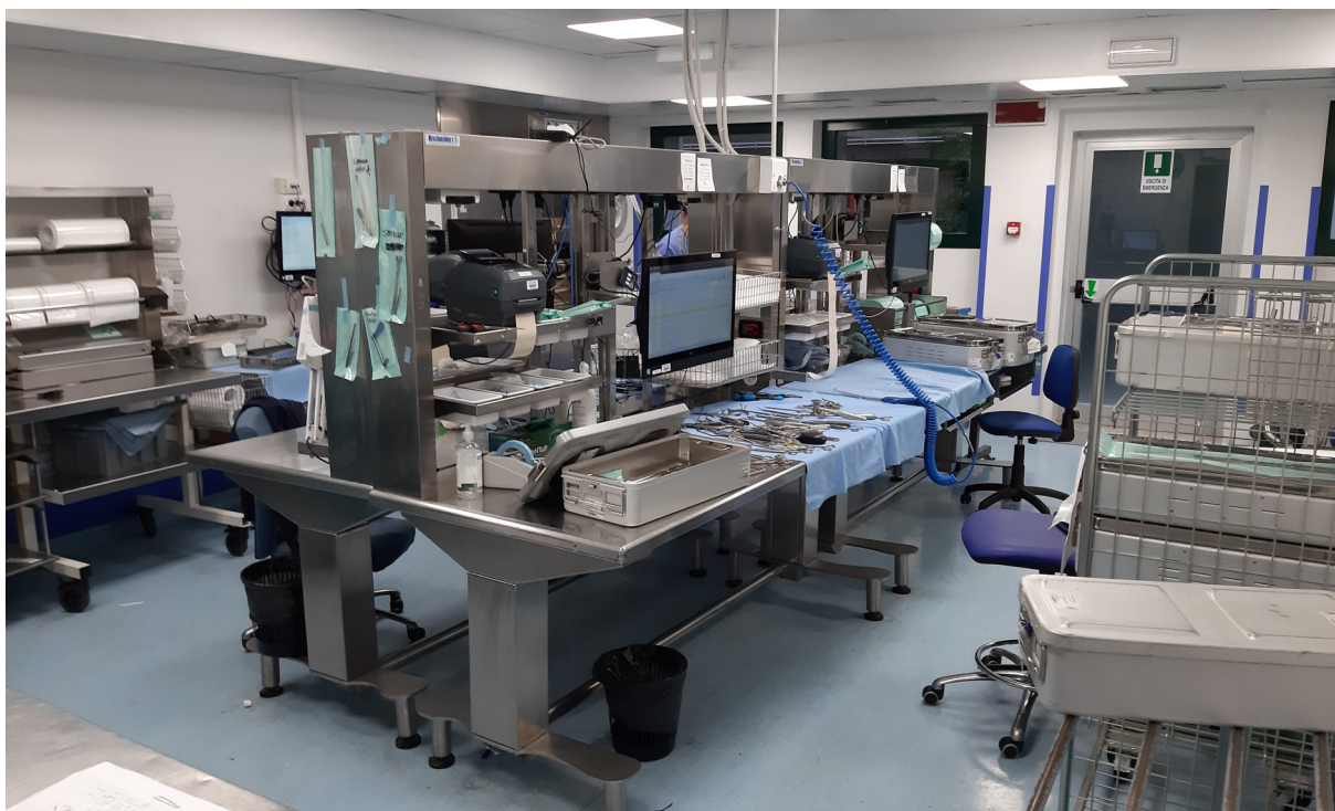
Figure 04.50 Un interno della centrale di sterilizzazione.
