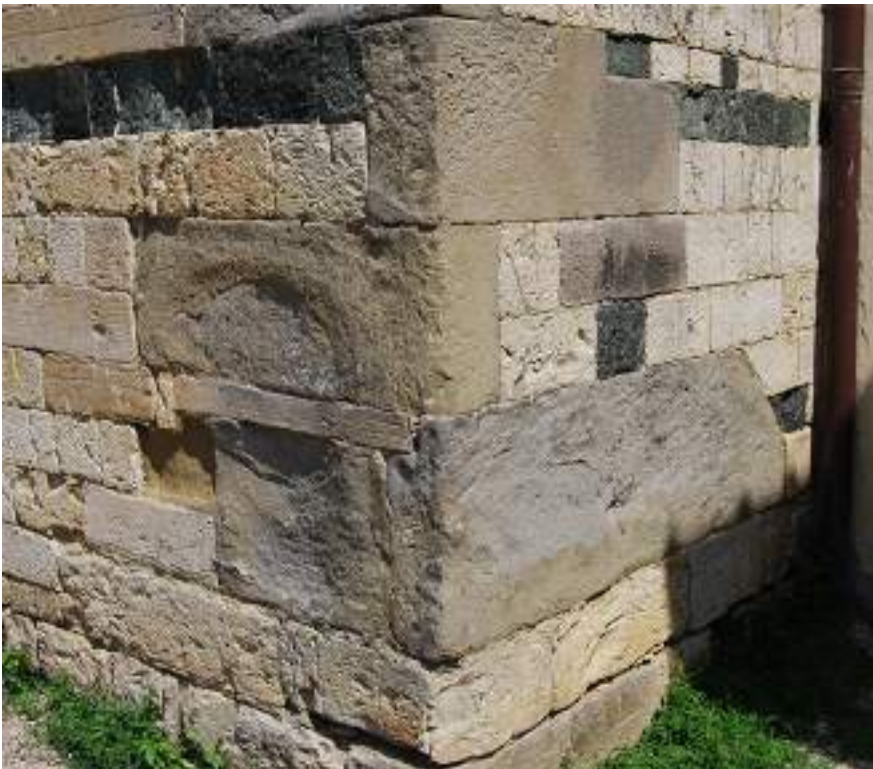
Fig. 120 Catene angolari in pietra serena presenti ai limiti inferiori della facciata della Pieve inserite nel corso degli interventi operati nella seconda fase costruttiva (probabilmente seconda metà del XIII secolo)
