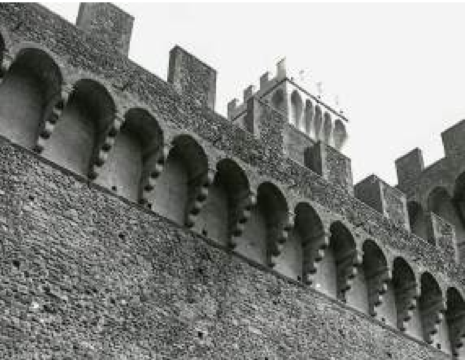
Fig. 42 Palazzo dei Vicari. Particolare delle mura dopo il restauro (Archivio SABAP Firenze n. 194722, 1997)
