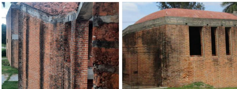
Fig. 26. Imágenes fotográficas que representan el estado de deterioro de la instalación. Fuente: elaborada por la autora.
