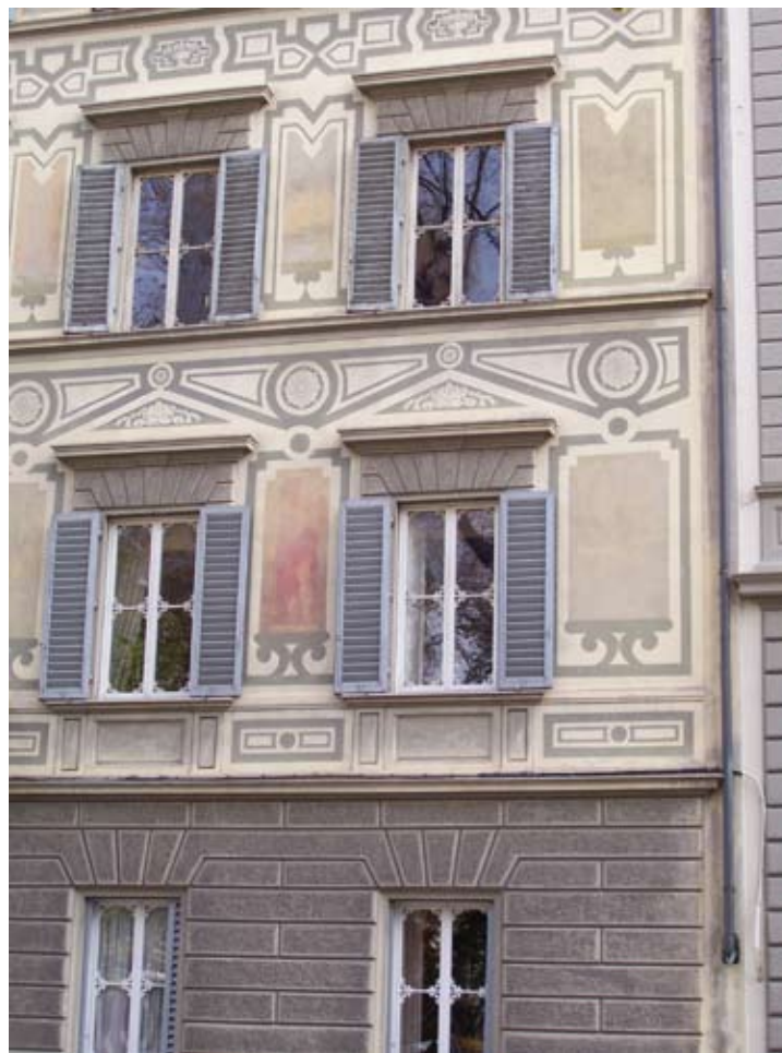
Facciata in Piazza d'Azeglio, es. di lacune pittoriche trattate con tinta neutra in presenza di rifacimento parziale della geometria dell'apparato decorativo
