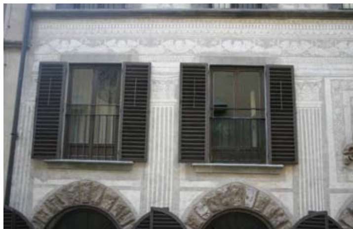
Palazzo n° 28, dettaglio dell'apertura delle finestre con distruzione di parte della decorazione
