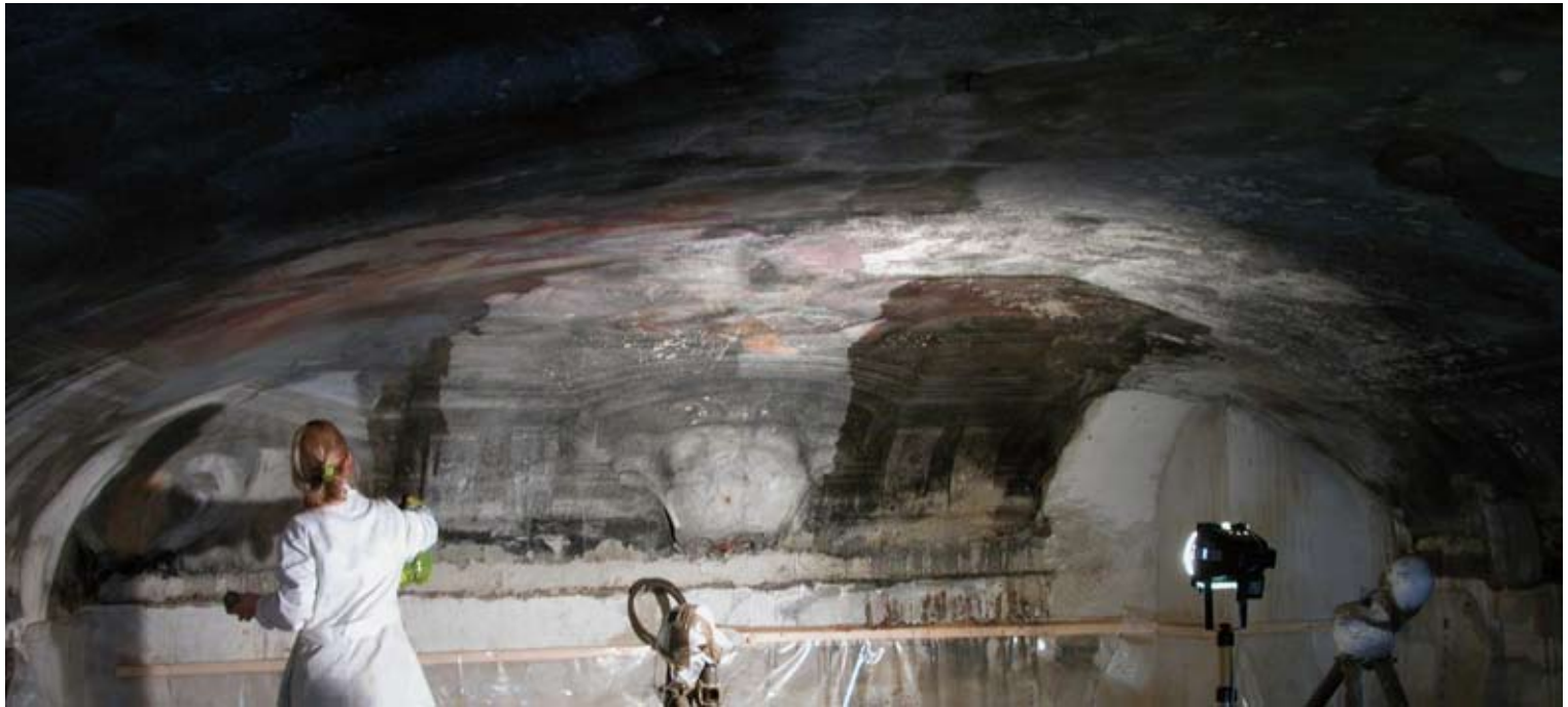
Sala della Fortuna. Condizioni iniziali in cui è apparsa la volta dopo la demolizione del contro soffitto. L'affresco risulta illeggibile e completamente annerito da un pesante strato di nerofumo combusto
