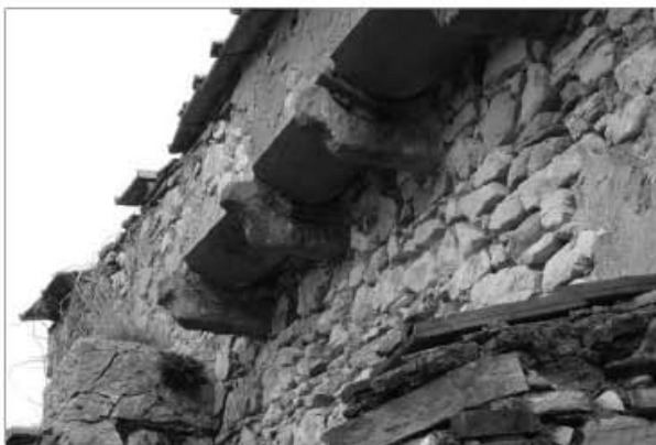
foto 5.3 particolare del sistema di scolo delle acque piovane
