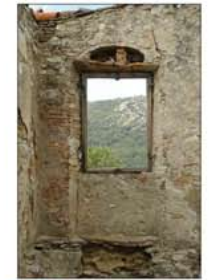
FOTO 18 Particolare apertura piano primo controparete del fronte
