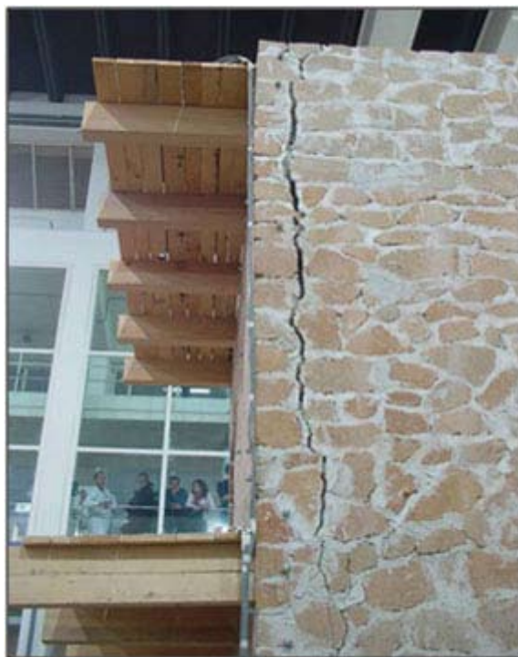
Figura 4: Lesione verticale sul cantonale tra la parete AD e CD (prova 0.25g).
