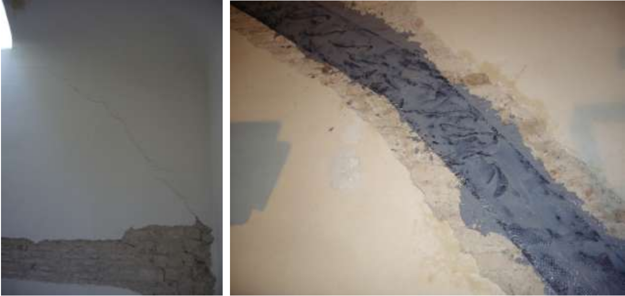
Stato fessurato di una parete in muratura ordinaria ed applicazione di materiali FRP per rinforzare la zona lesionata
