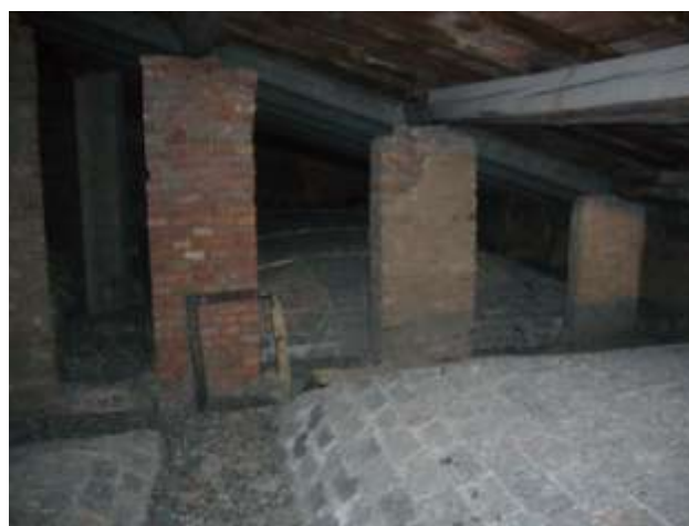
Stato esistente di una porzione di copertura in legno e estradosso di volte in foglio a padiglione
