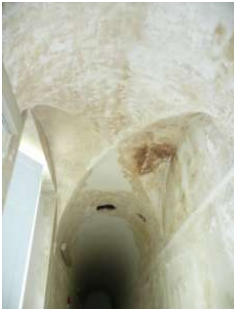
Controsoffitto esistente e deteriorato
