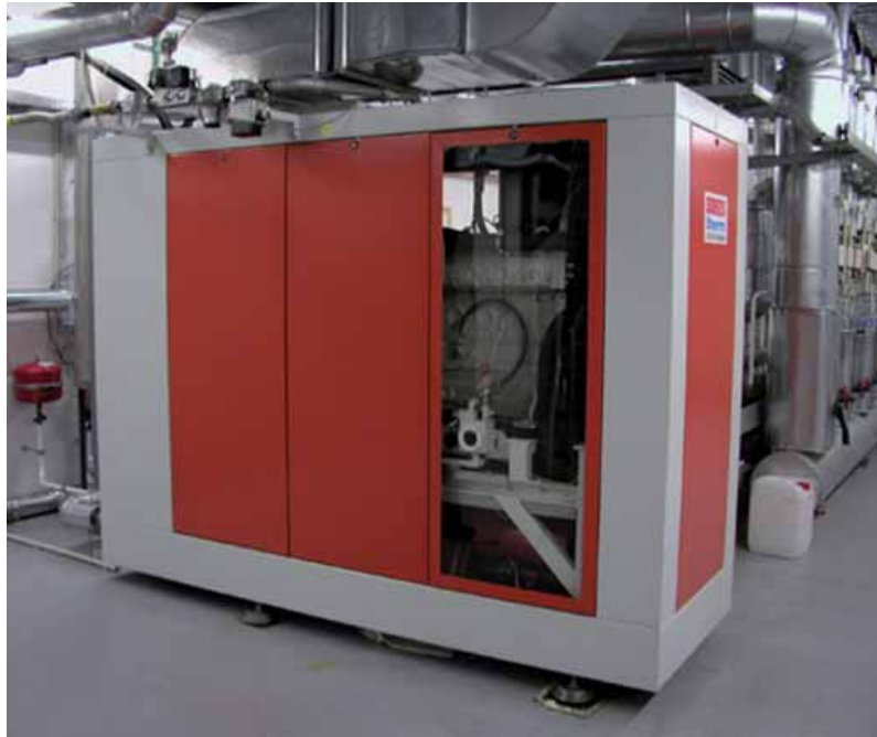
Impianto di cogenerazione.
