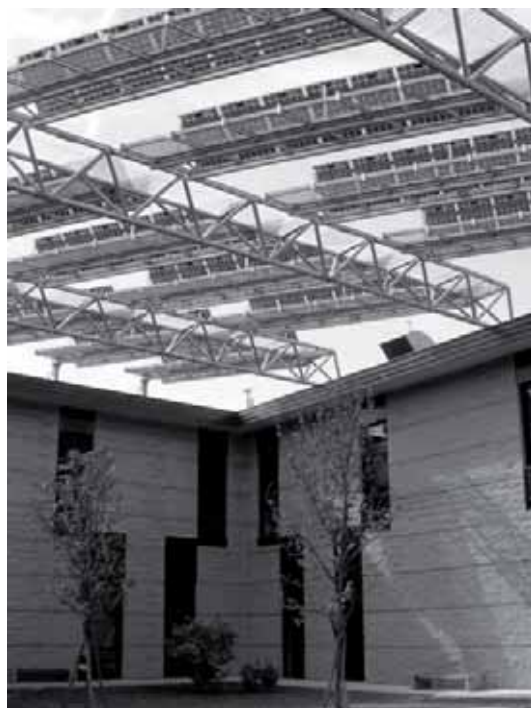
Fig. 3.25 Integrazione di un sistema fotovoltaico per la copertura di una corte interna.
