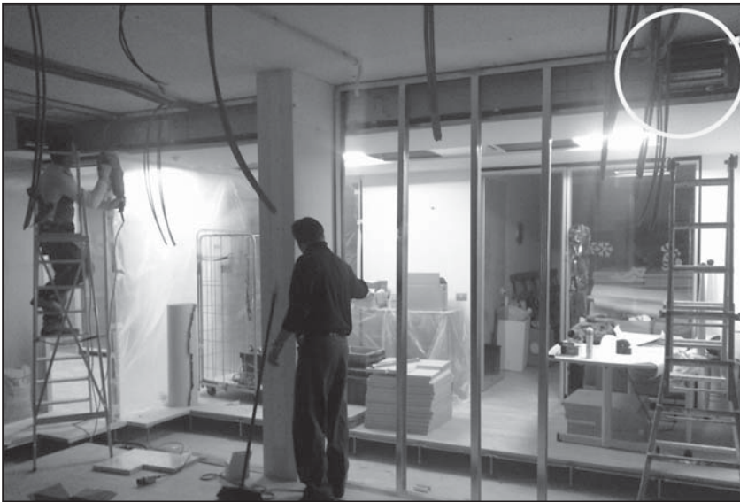
Fig. 9 – Avanzamento lavori, in evidenza in alto a destra la bocchetta di mandata dell'aria
