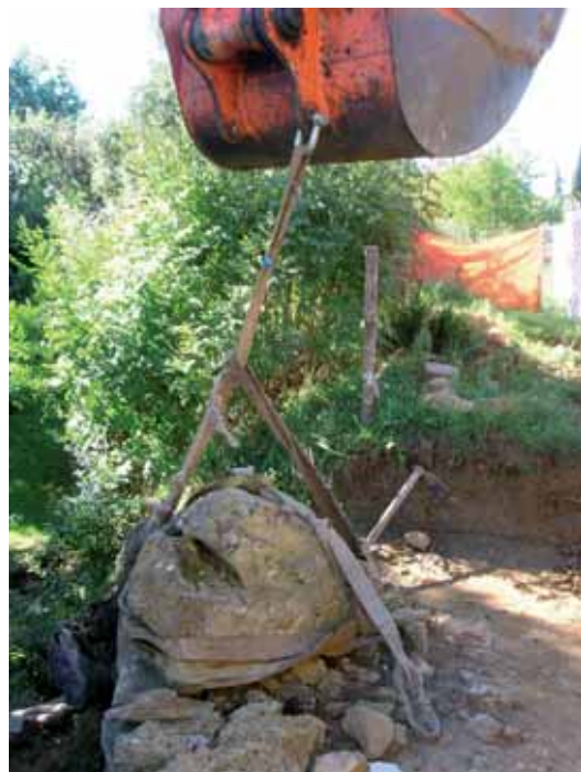
fig. 101 - Torricella: ricollocazione in asse con il muro di un blocco dislocato.
