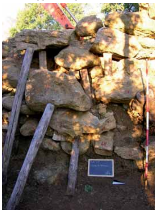
fig. 99 - Torricella: particolare del dissesto del muro etrusco sul lato est, con numerazione dei blocchi.
