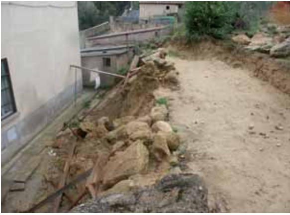
fig. 70 - Golfuccio – tratto di muro crollato.
