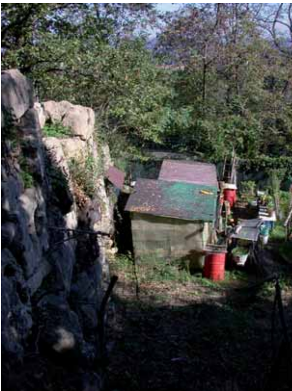
fig. 58 - S. Andrea - fronte principale con superfetazioni e violazioni della struttura antica.
