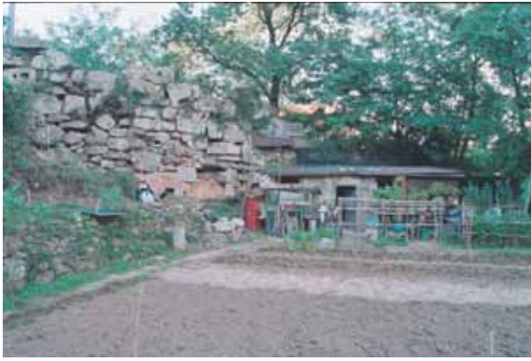
fig 22 - Muro in località S. Andrea prima del restauro.
