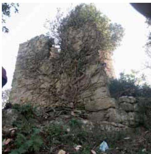
fig. 92 - Torricella: vegetazione infestante sulla torre
