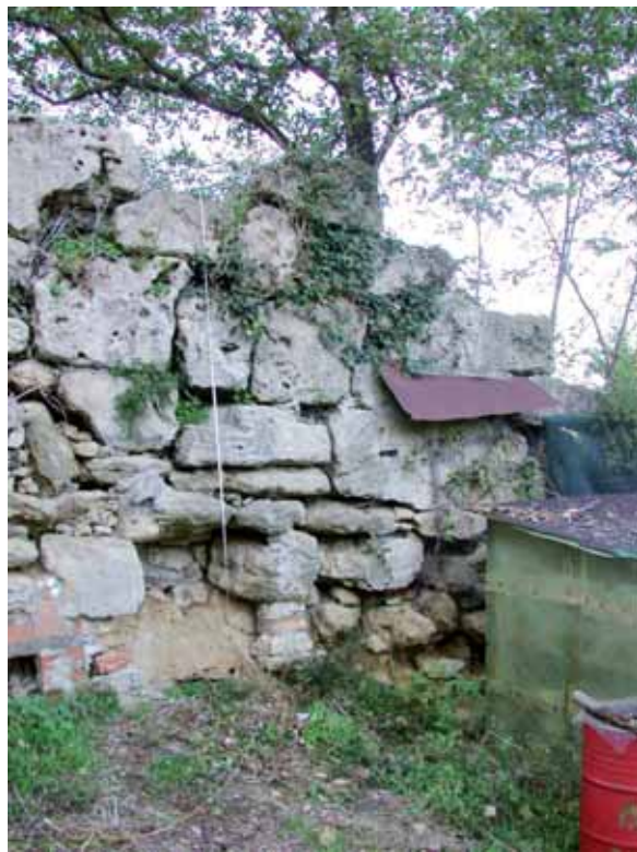
fig. 59 - S. Andrea - fronte principale particolare superfetazioni e violazioni della struttura antica.
