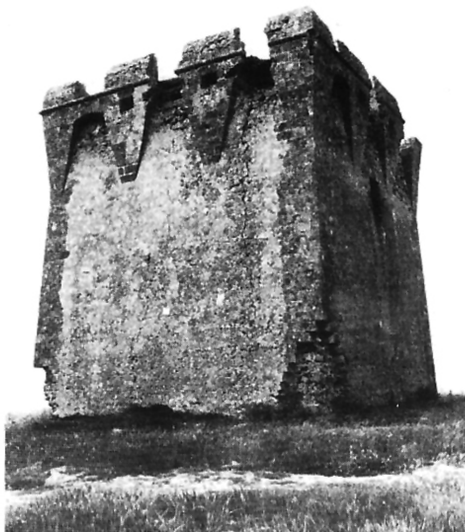
104. Torre Boraco. La torre ripresa da sud-est. È evidente la lesione provocata dal crollo del soffitto del vano interno.
