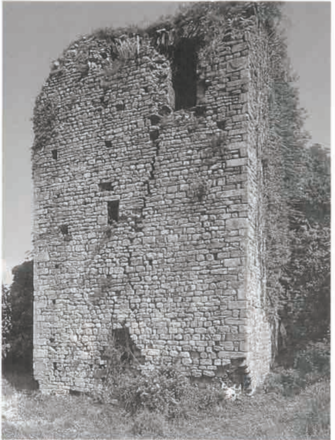
Le rovine del medievale castello di Grossolano, strategicamente posto a cavallo della via che dalla Lavinia si conferisce in Tuscania. Nella pagina seguente, l'altare, distrutto dal crollo, che si sta allestendo di Villanova.
