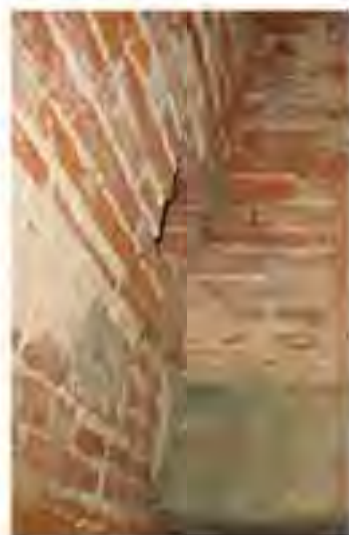
Fig. 125 - Cupola di Santa Maria dell'Umiltà di Pistoia. Particolare di uno spigolo: in alto, tra vele adiacenti e in basso, tra vela e costolone. E' evidente la mancanza di ammorsamento
