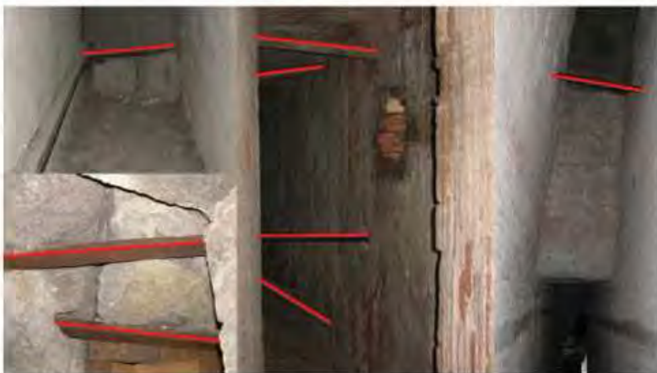
Fig. 138 - Catene metalliche trasversali introdotte per contrastare le lesioni sui costoloni mediani e sui costoloni della lanterna (secondo gruppo) dovute al movimento relativo dei due gusci. A sinistra, le catene inserite a livello del tamburo; al centro e a destra, le catene inserite nella cupola
