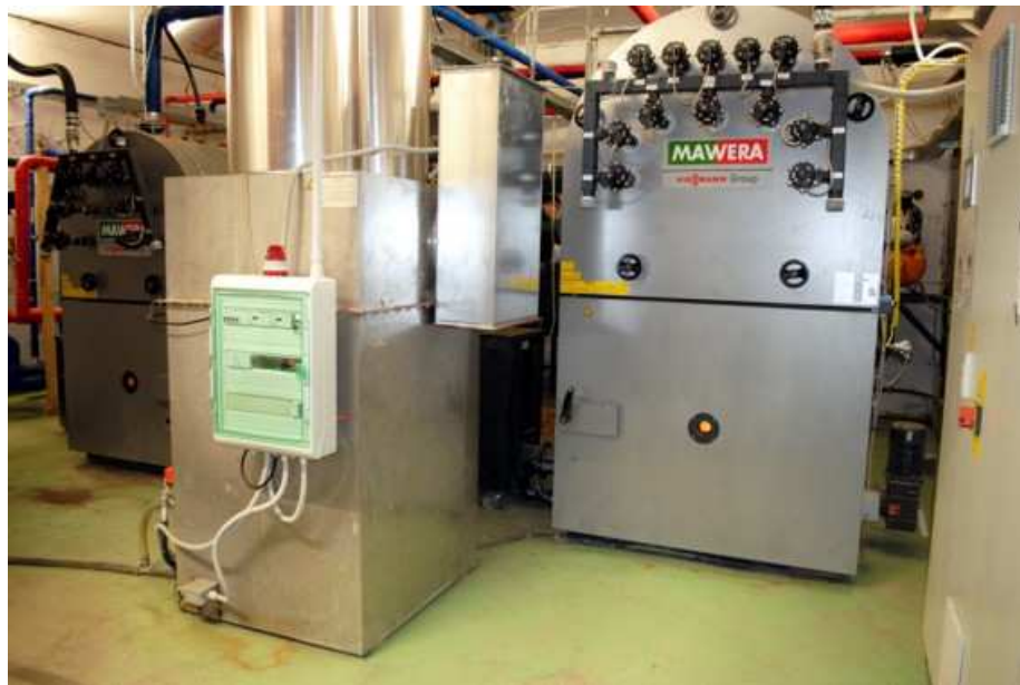
Foto 4. Centrale di teleriscaldamento a cippato di Vallombrosa.
