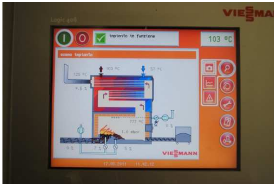
Foto 6. Display per il controllo del funzionamento di una delle caldaie Mawera installate nella centrale termica di Vallombrosa.
