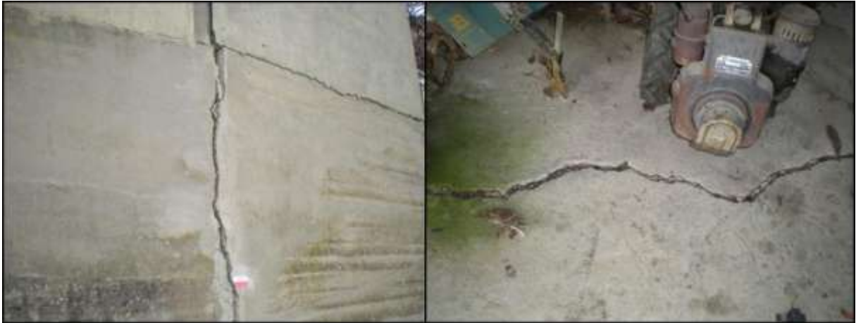
Figura 17 fratture rilevate negli edifici perimetrali del paese.
