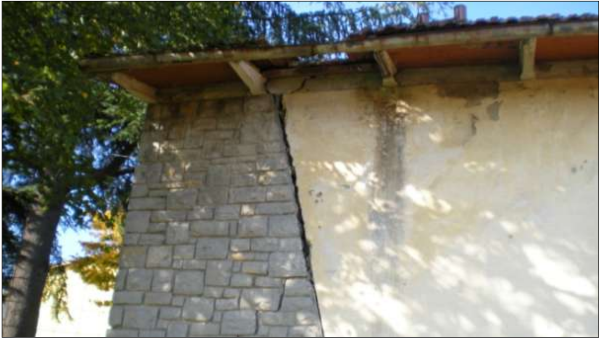
Figura 14 Lesione nel muro perimetrale dell'ex- scuola elementare, situata nel versante meridionale del paese.
