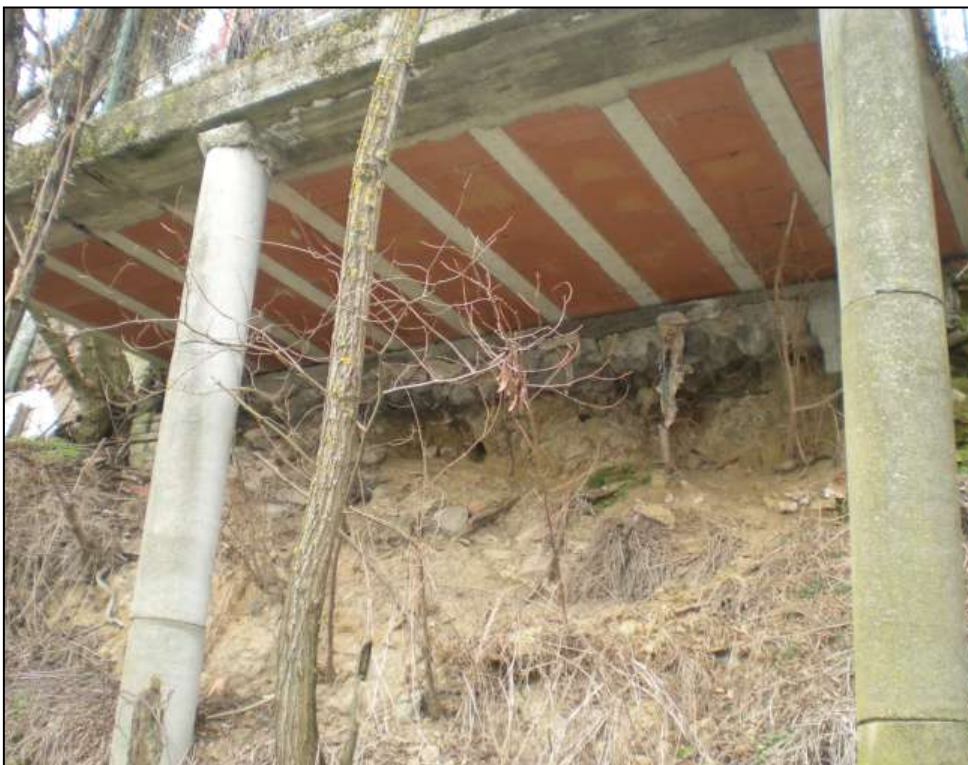
Figura 15 arretramento della scarpata sotto il manto stradale nel versante settentrionale del paese.
