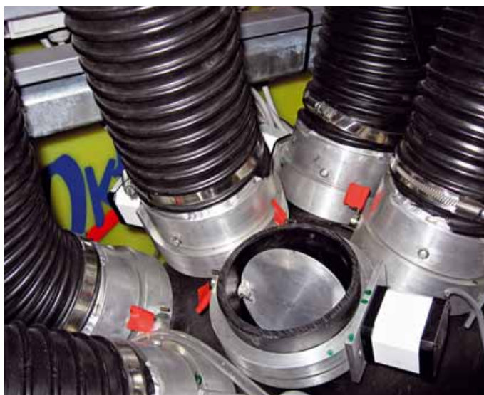
Complesso di valvole a farfalla per la gestione dell'aria dei singoli moduli
