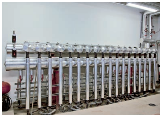
Fig. 25.15 Centrale termica arrivo delle sonde geotermiche.
