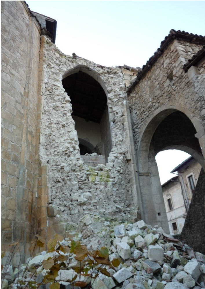
Fig. 17 – Centro storico di Sant’Eusanio Forconese, porzione absidale della chiesa del Santo Patrono
