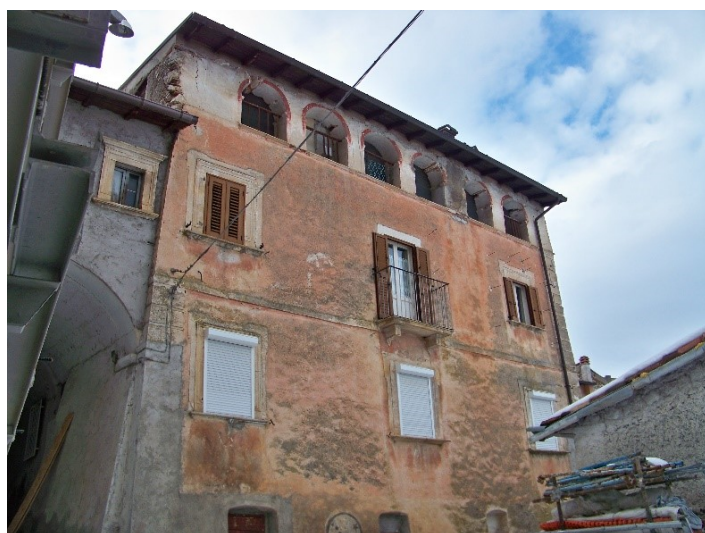
Fig. 19 – Casentino, degrado delle cromie esistenti
