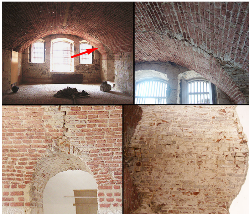
Figura 8. Las lesiones (lesión 3 - bóveda 2) que son objeto de estudio y la conformación del falso arco del pasaje.
