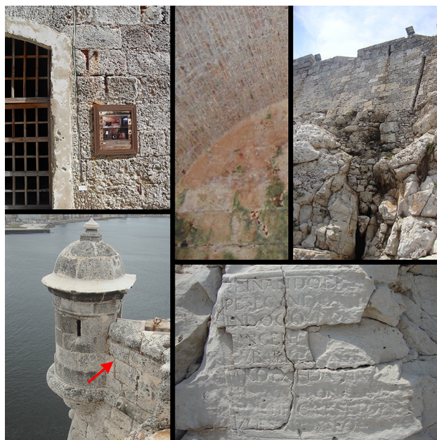
Figura 4. Algunos actuales casos de emergencia de degradación: (desde arriba izquierda) erosión del mortero y de la piedra, humedad en los espacios interiores, la fractura en la base rocosa, las lesiones en el parapeto que enlaza la estructura de la garita y al final la erosión que está dañando la antigua inscripción.
