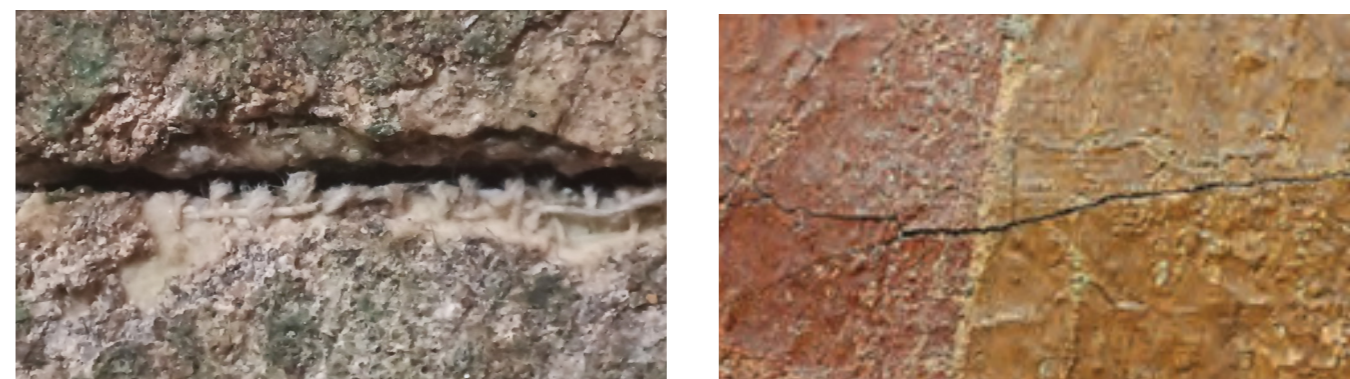
Fig.2.23 formazione di cretti sulla pellicola pittorica di alcuni affreschi del chiostro Verde.
