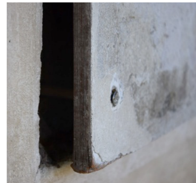
Fig.1.19 deformazioni localizzate sulle aree dove ha ceduto il sistema di ancoraggio alla parete.
