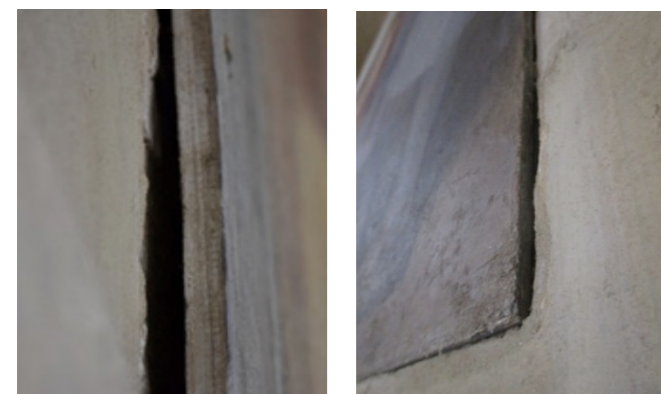
Fig.2.21 deformazioni strutturali dei supporti in masonite presenti nel chiostro Verde.
