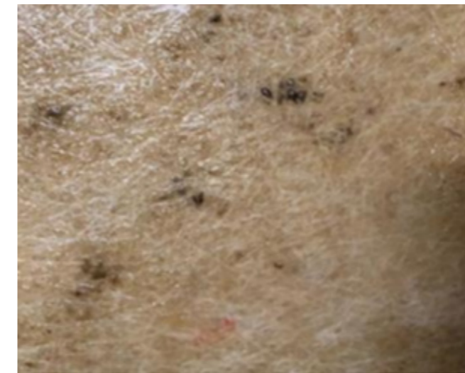
Fig. 1.17 attacco biodeteriogeno su pannello di vetroresina.
