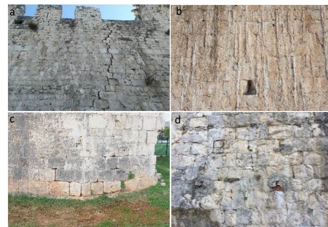
Fig. 6.21 varie tipologie di degrado presenti nel castello del Kamerlengo: a) dissesti strutturali, b) concrezioni stalagmitiche della muratura, c) perdita della malta di allettamento tra i conci di pietra calcarea, d) scagliatura e fessurazione dei conci di facciata.
