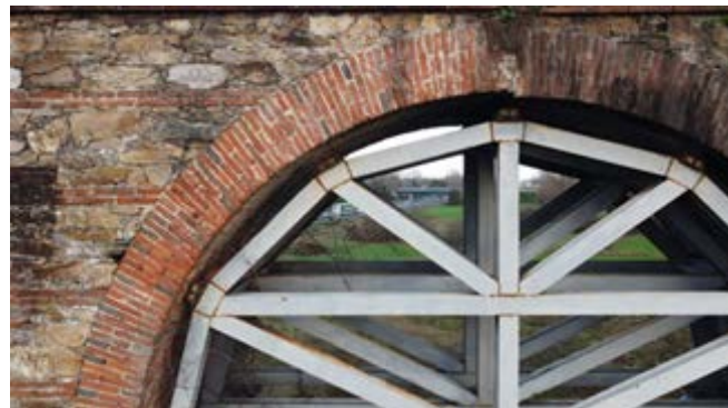
Figura 7: Lucca, Acquedotto del Nottolini, Particolare di un'arcata in prossimità dell'interruzione con l'Autostrada, 2023.
