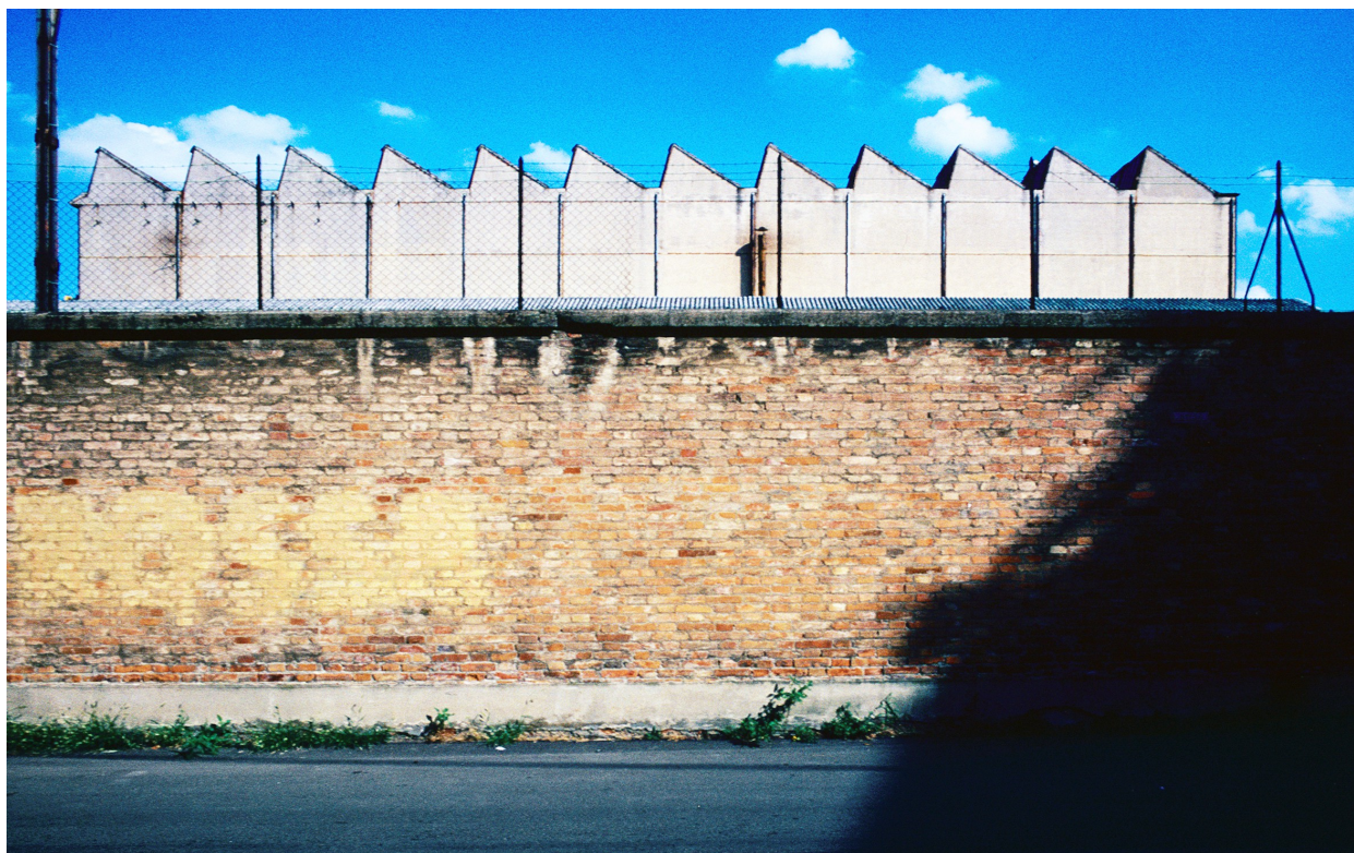
Figura 1: Stabilimento della Riva Calzoni in disuso a Bologna prima di essere abbattuto negli anni '90.
