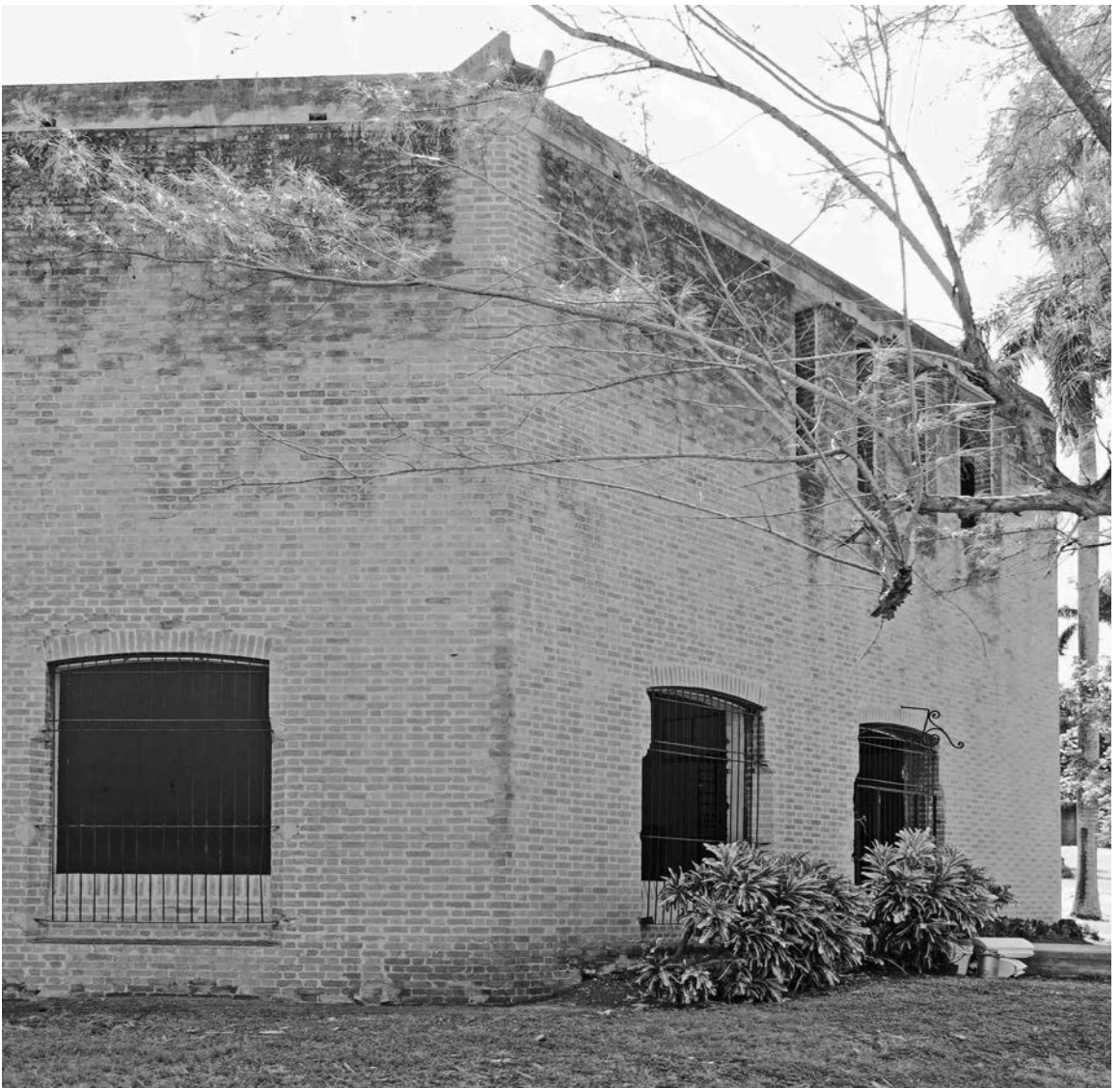
Fig. 17 | Alzado exterior del bloque 5. (créditos: CHM_Lab) | Prospetto esterno del blocco 5 (credits: CHM_Lab).
