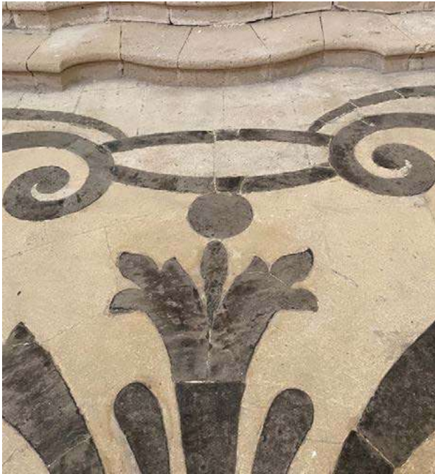
Fig. 5 Siracusa, chiesa di S. Filippo Neri, pavimento, particolare lato altare Crocifisso, con l'integrazione e lo stato materiali, dopo 61 anni dal restauro (foto O. Schillaci, 2023)
