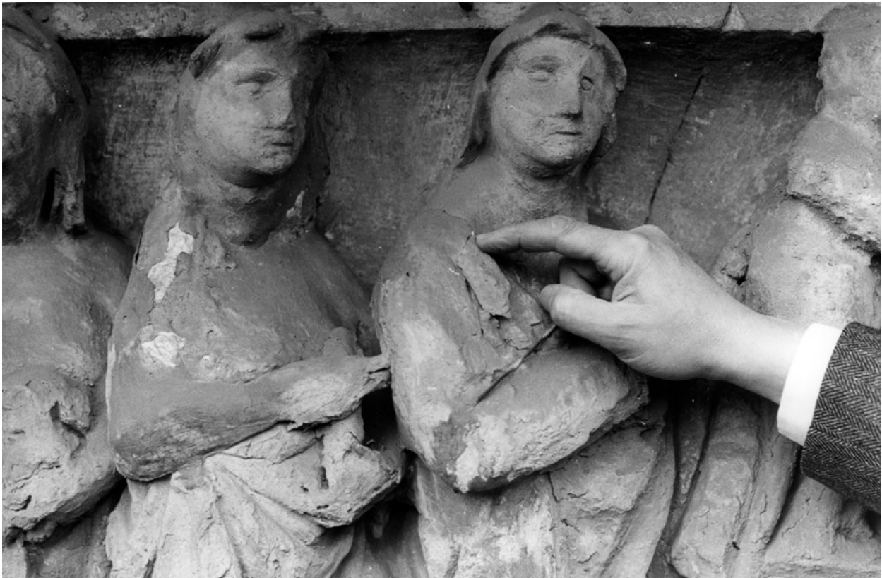
Fig. 4 Siena, Duomo, Portale di Tino da Camaino. Verifica dello stato di polverizzazione dei rilievi durante un sopralluogo di Piero Sanpaolesi. Foto 20 giugno 1967 (Archivio DIRES, Firenze, n.493/11)
