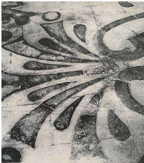
Fig. 4 Siracusa, chiesa di S. Filippo Neri, pavimento, parte destra prima del restauro, particolare, si notano abrasioni, disgregazioni e lacune (foto Lojacono, 1962)
