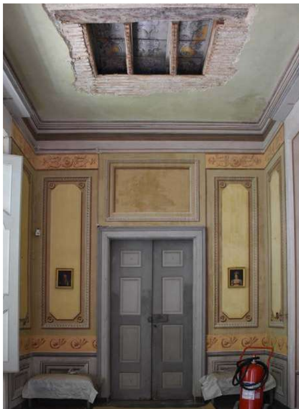
Fig. 5 Castello di Agliè, apertura nel plafone ligneo ottocentesco della Galleria dei morti , 2023. Si intravede la decorazione all'intradosso del solaio preesistente, emersa in seguito alla campagna di indagini diagnostiche condotta nel 2007 (foto D. Arpellino 2022).
