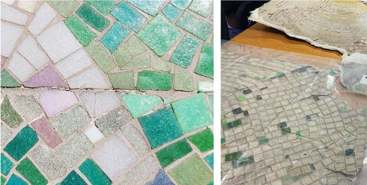
Fig. 3 Napoli, Mosaico di Domenico Spinosa, sede della Facoltà di Architettura di Piazzale Tecchio. A sinistra: dettaglio del rivestimento con tessere di pasta vitrea in cui si evidenzia la giuntura tra due diversi pannelli (foto S. Iaccarino 2023); a destra: campione di pannello strappato poiché quasi totalmente distaccato dal supporto. Su di esso saranno condotte analisi per comprendere la composizione della malta e dei collanti d'allettamento (foto R. Picone, 2022).
