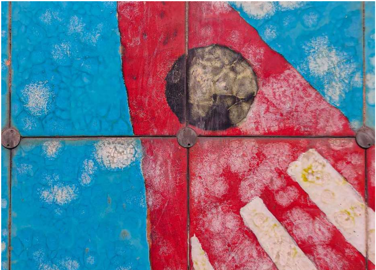
Fig. 4 Napoli, partito decorativo di Paolo Ricci collocato sulla facciata principale della sede della Facoltà di Architettura di Piazzale Tecchio. Stato di conservazione delle piastrelle ceramiche in cui si evidenziano delle concrezioni minerali che hanno alterato la consistenza e il colore delle stesse (foto S. Iaccarino 2022).
