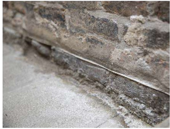
Fig. 5 Ferrara, Palazzo Renata di Francia, barriera meccanica (foto M. Montuori 2016).
