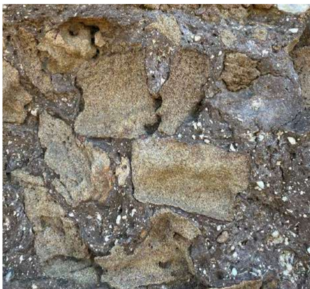
Fig. 2. Torre Testa (BR). Efflorescenze saline sul conglomerato di malta di calce e pietrame calcareo del nucleo interno.
