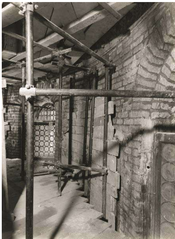
Fig. 2. Opere provvisorie per le murature dell'abside maggiore durante le iniezioni cementizie a pressione, (Università Iuav di Venezia, Archivio Progetti – Fondo Ferdinando Forlati)
