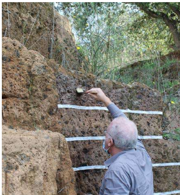
Fig. 4 Cerveteri, Altopiano delle Onde Marine, l'applicazione dei formulati protettivi sulla parete di una cava etrusca (foto T. Vagnarelli 2020)
