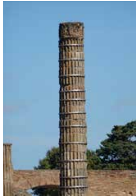
145. Pompei, la Palestra, lesioni alle colonne dovute alle tensioni provocate dall'“anima” in cls
