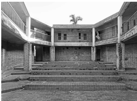
Fig. 19 | Platea del patio hexagonal diseñado para estar sin cubierta, al aire libre, en la Escuela de Artes Escénicas de Roberto Gottardi (créditos: Vegas & Mileto). | Platea del teatro esagonale progettato per rimanere privo di copertura, all'aperto, presso la Escuela de Artes Escénicas di Roberto Gottardi (credits: Vegas & Mileto).
