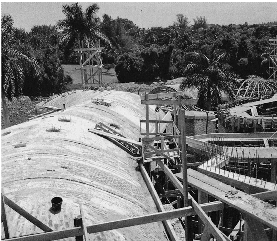
Fig. 16 | Vista de las cúpulas de la Escuela de Teatro en construcción (cortesía de Roberto Gottardi). | Vista delle cupole della Scuola di Teatro in costruzione (cortesía di Roberto Gottardi).
