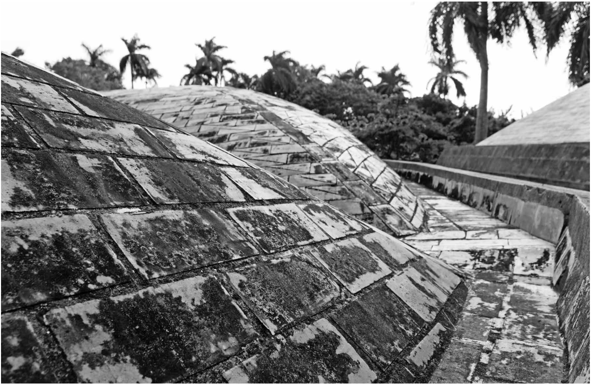
Fig. 13 | Biodeterioro por presencia de microflora (créditos: Alessandro Merlo). | Biodeterioramento dovuto alla presenza di microflora (credits: Alessandro Merlo).
