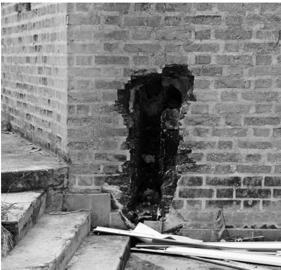
Fig. 8 | Elección tecnológica que implicó un deterioro de los materiales constructivos (créditos: Stefania Aimar). | Scelta tecnologica che ha implicato un deterioramento dei materiali da costruzione (credits: Stefania Aimar).
