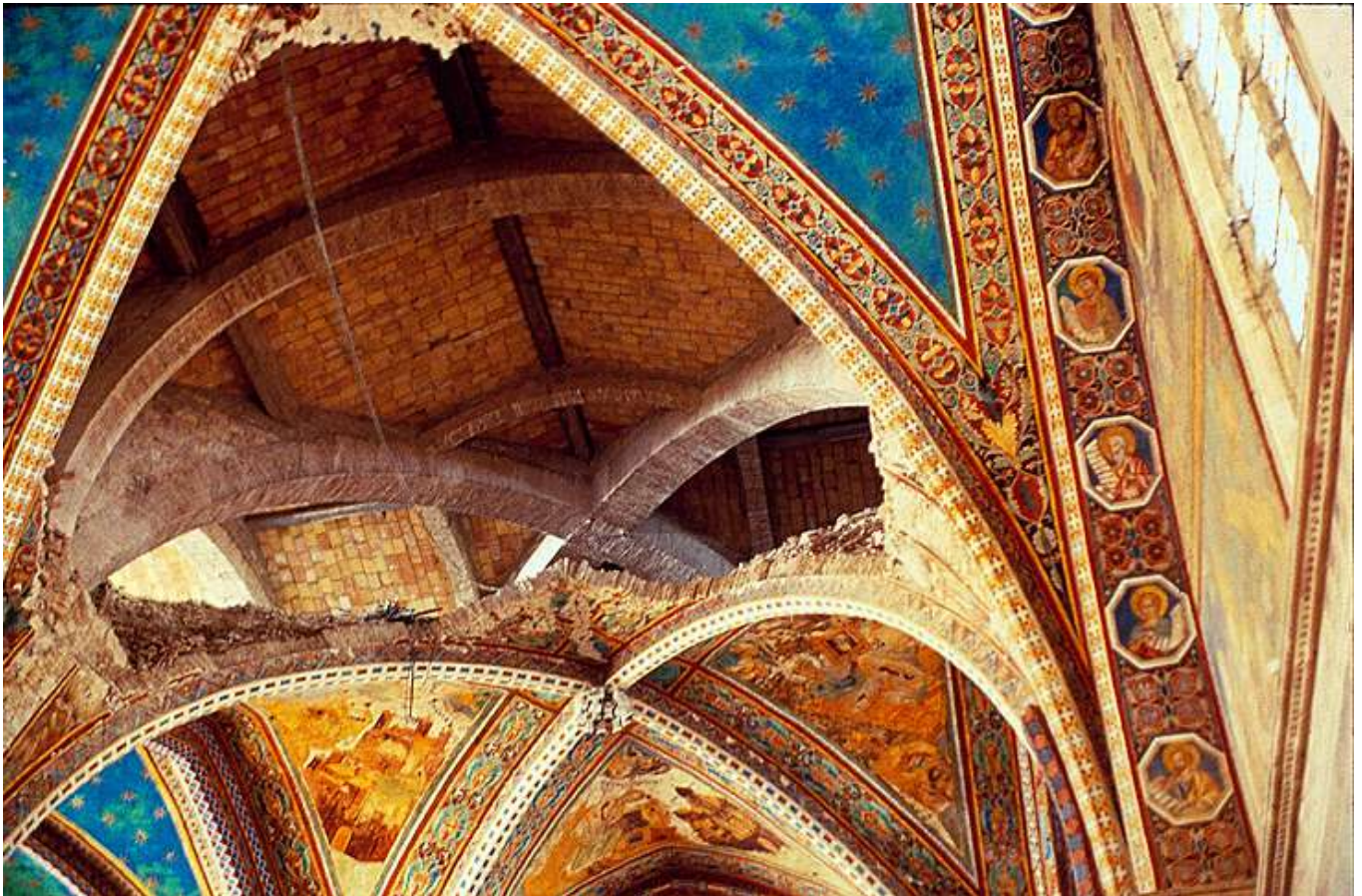
Fig. 6.19 Assisi, le volte della chiesa Superiore dopo i crolli in seguito al terremoto del 1997.
