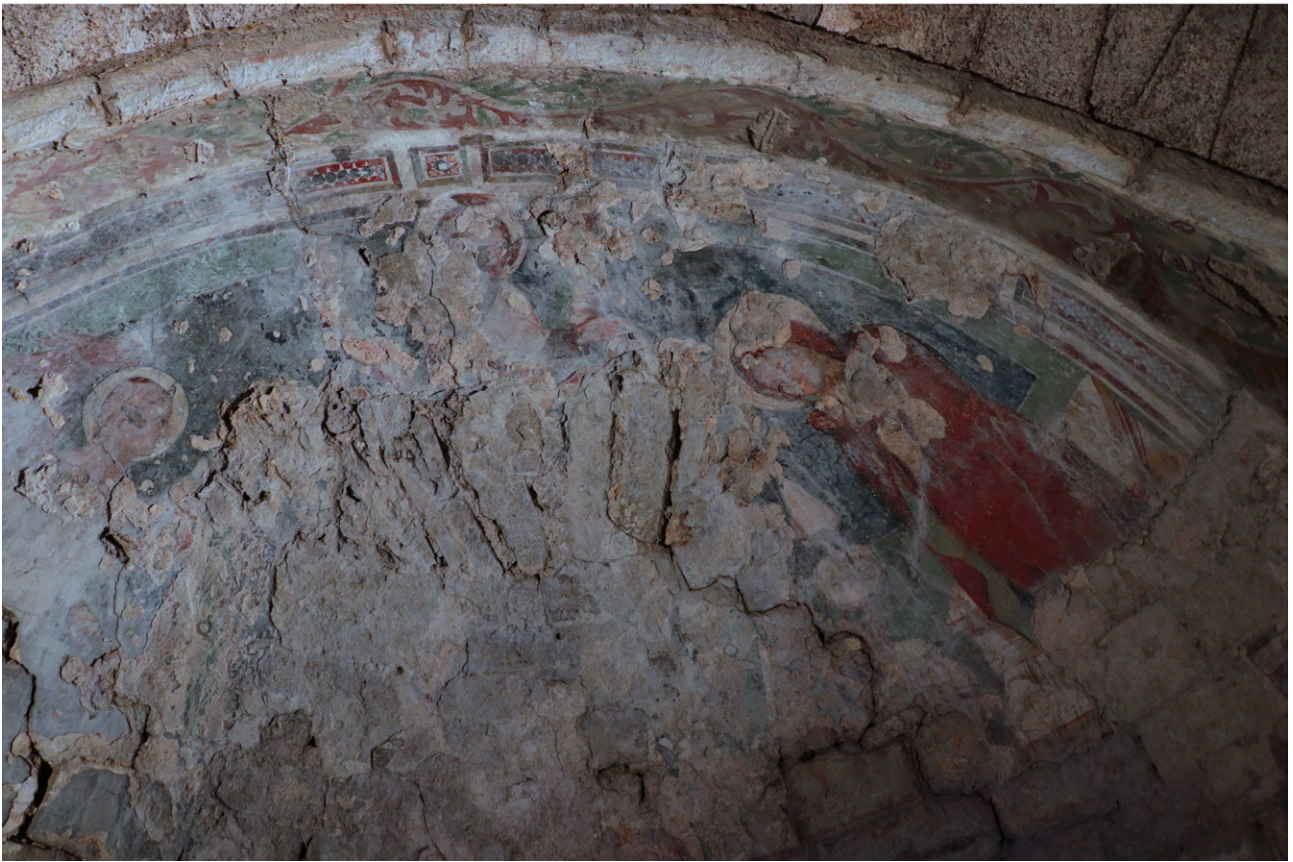
Fig. 2. Almenno San Bartolomeo (BG), Rotonda di San Tomè, lesione sul lato ovest dell'aula (in alto) e sulla copertura dell'absidiola della galleria (in basso) (foto M. Gualdi 2022).
