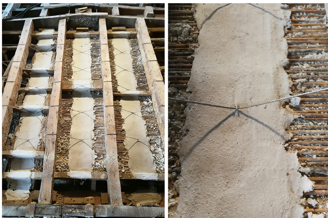
Fig. 5. Monticello Brianza (LC), Villa Greppi, consolidamento dell'estradosso con fasce di fibra di basalto ricoperte da malta igroscopica traspirante a base di calce naturale pura e con cavi in acciaio per il miglioramento della connessione centine-stuoio (da ANNESSI et al. 2020, p. 44).
