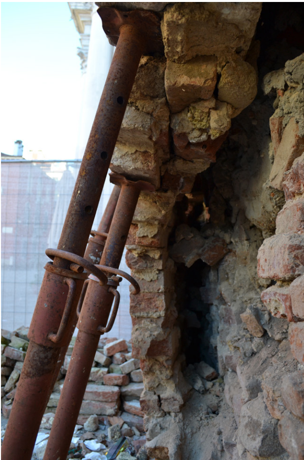
Fig. 3. Venezia, il dissesto mette in luce una sezione resistente ottenuta attraverso l'accostamento di paramenti distinti. La scarsità della qualità costruttiva, assieme al degrado della muratura, chiarisce il comportamento e indirizza l'intervento di miglioramento strutturale (foto I. Zamboni 2021).
