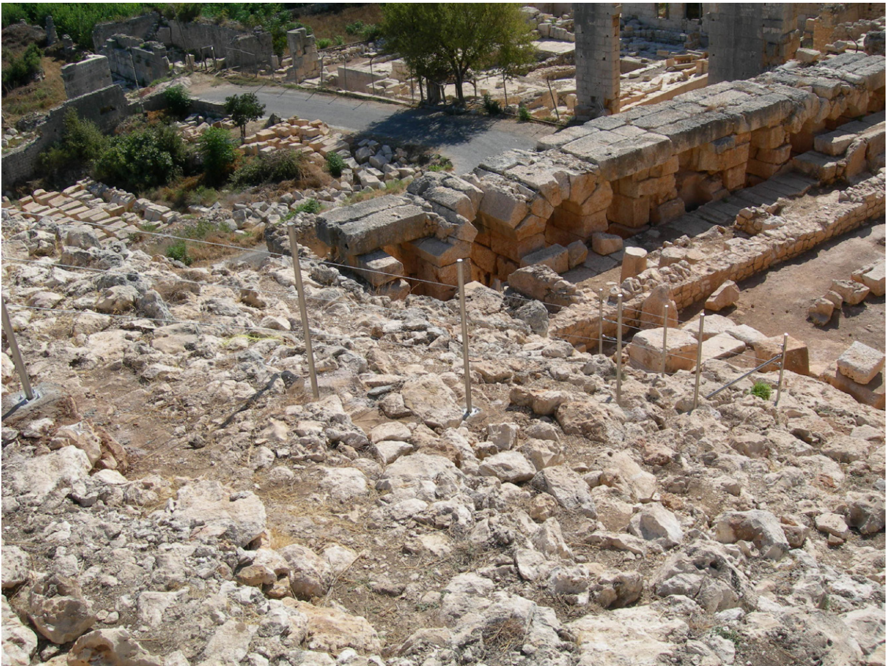
Fig. 5. Mersin (Turchia), Elaiussa Sebaste, particolare dell'intervento riguardante la cavea del teatro. Il sistema di recinzione in tubolari e cavi d'acciaio impedisce l'accesso alle aree non ancora messe in sicurezza, garantendo l'incolumità dei visitatori, e delimita lo spazio visitabile del monumento escludendo provvisoriamente le porzioni ancora oggetto di scavo. Il sistema modulare consente di modificare il percorso sulla base della progressione dei lavori (foto E. Romeo 2006).
