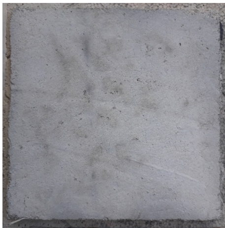
Figura Analisi e discussione dei risultati-113: Dettaglio fessurazione T50_50_01.
