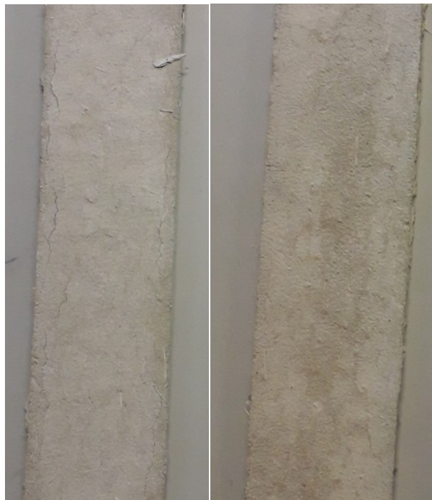
Figura Analisi e discussione dei risultati-66: Dettaglio comparsa fessurazioni longitudinali, WDL_30_01 e WDL_50_01.
