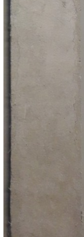
Figura Analisi e discussione dei risultati-72: Dettaglio comparsa fessurazioni longitudinali, WDS_50_02.
