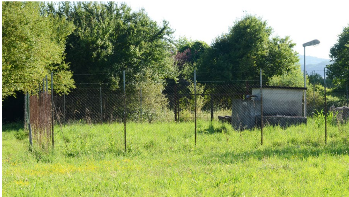
Figura 32 Unità di pompaggio del campo pozzi per l'alimentazione dell'acquedotto (© UNIFI DIDA Landscape Design Lab, 2021)
