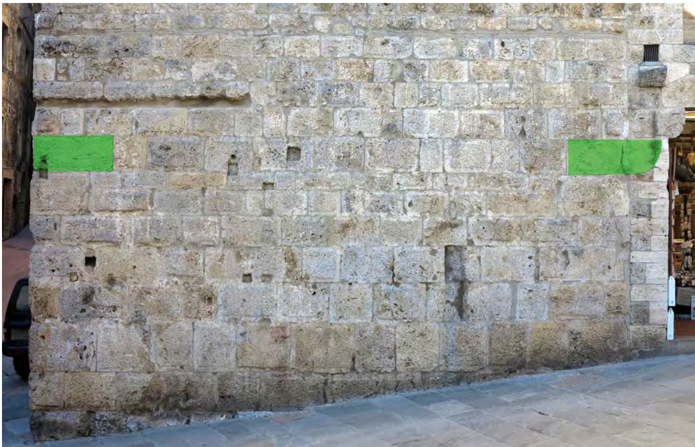
Mensola lapidea spezzata all'angolo sud-orientale della torre (verde a sinistra) e mensola analoga lesionata nell'angolo nord-orientale all'attacco del palazzo (verde a destra).
