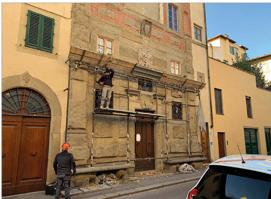
Fig. 3 – Firenze, palazzo Zuccari. La facciata prima del restauro (foto Direzione lavori).
