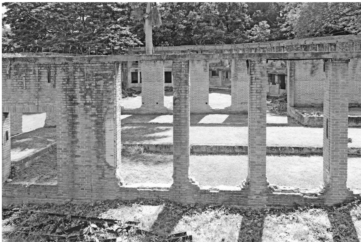
Fig. 39 | Pilares y tabiques de mampostería del bloque 13 (créditos: CHM_Lab). | Pilastrì e setti in muratura del blocco 13 (credits: CHM_Lab).
