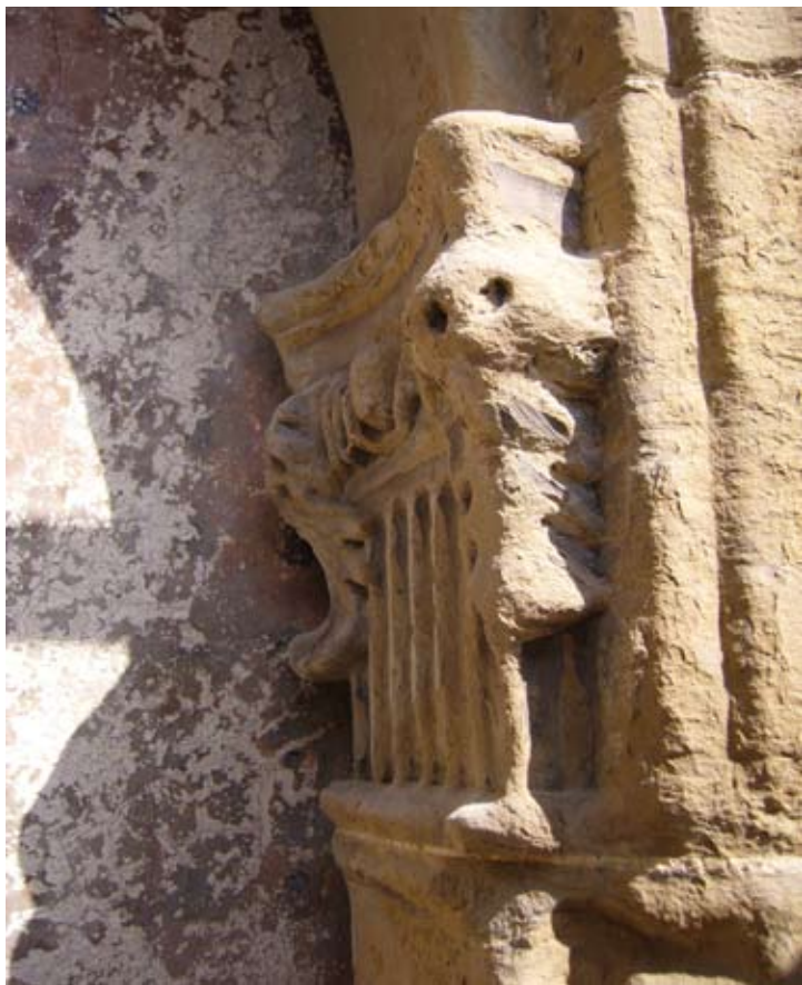
Palazzo Medici Riccardi, facciata laterale, es. di degradazione della pietra arenaria e della decorazione pittorica "trompe l'oeil" della finta finestra
