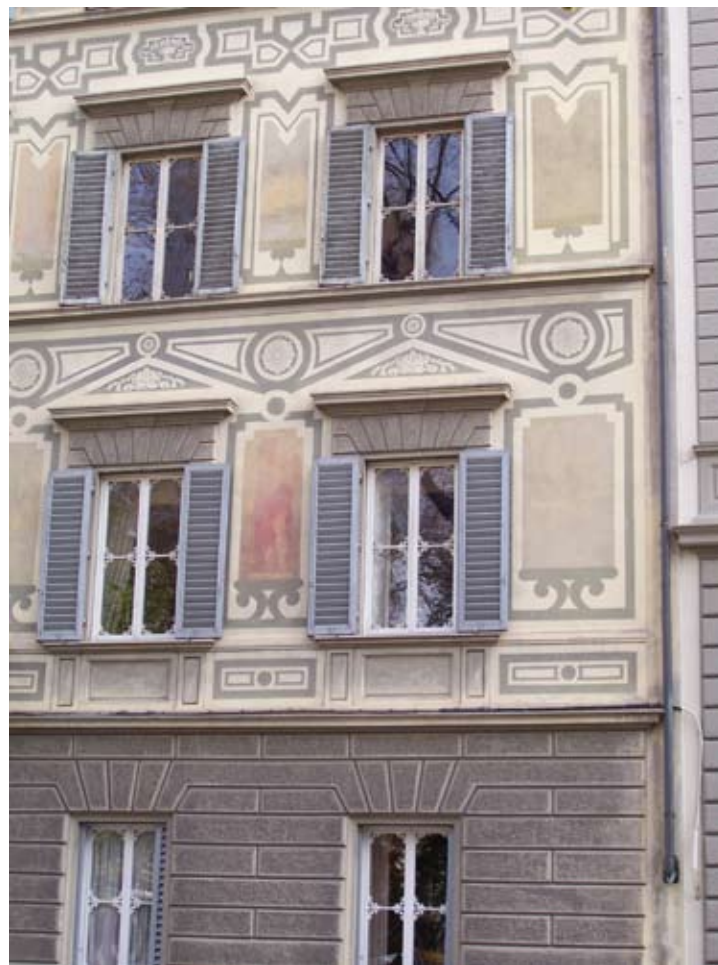
Facciata in Piazza d'Azeglio, es. di lacune pittoriche trattate con tinta neutra in presenza di rifacimento parziale della geometria dell'apparato decorativo
