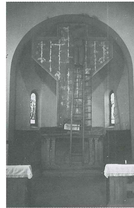
Fig. 11. Fotografia datata Agosto 1957 che mostra il muratore intento a dare gli ultimi ritocchi alla copertura di tegoloni di cotto applicati sulla struttura in cemento armato, prima della successiva stesura dell'intonaco (gentilmente fornita dal parroco Don Bruno Brezzi).
