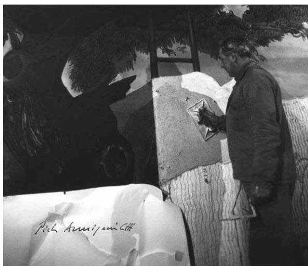
Figura 2 – Il muratore stende la malta a base di calce per il velo della giornata da affrescare, al di sopra dell'arriccio precedentemente irruvidito con una forchetta.
