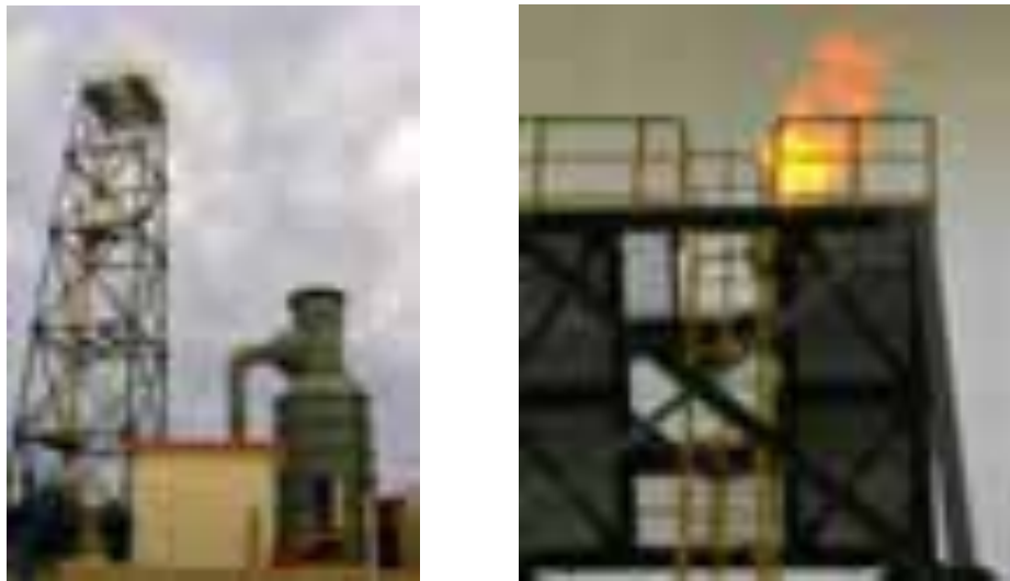
Figura 27: Fasi di attività sperimentale durante la prima accensione del Derrick
