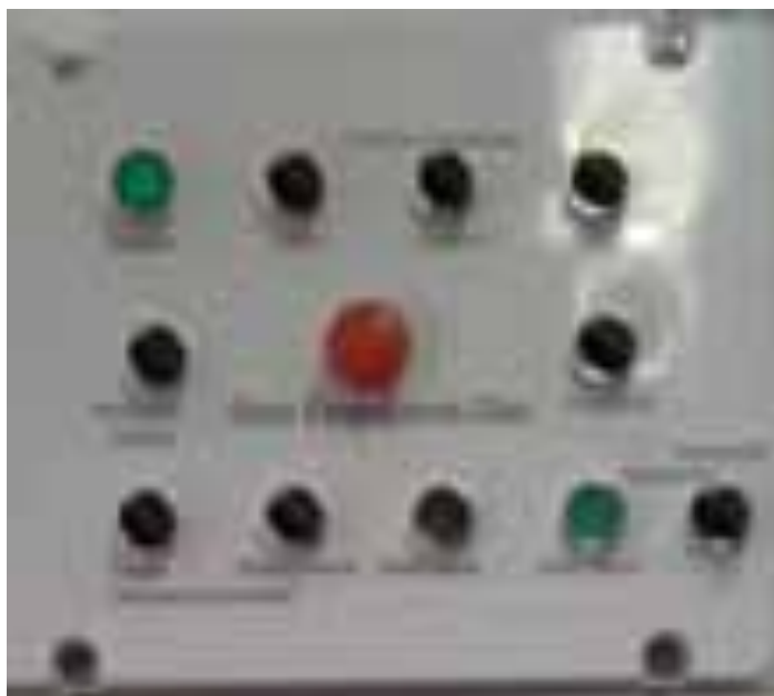
Figura 91: Quadro di controllo ausiliari e blocchi di sicurezza
