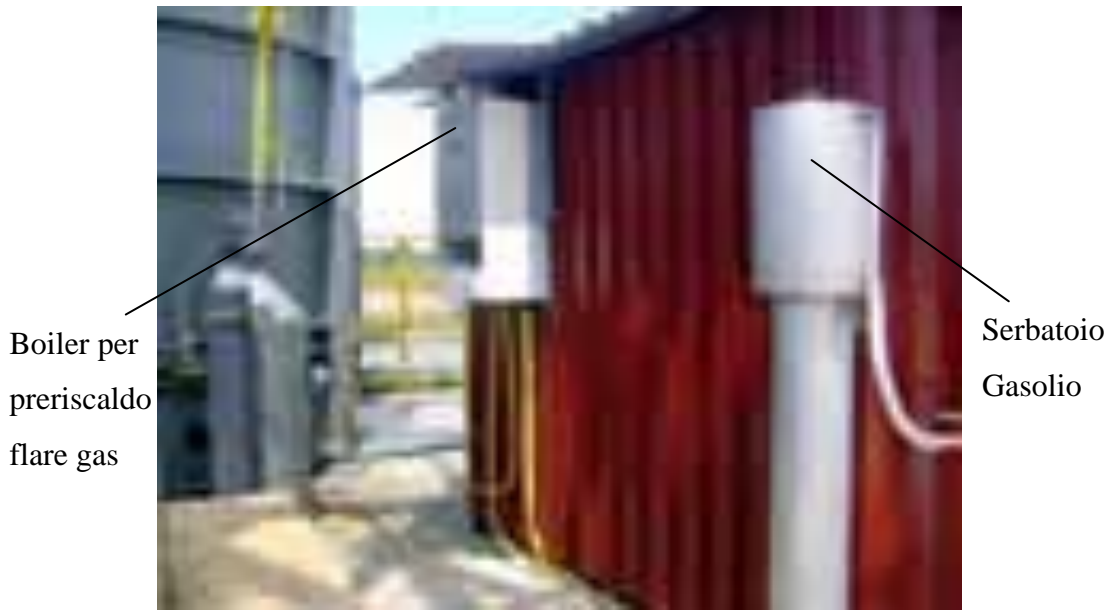
Figura 89: Foto del serbatoio di gasolio e della caldaietta di preriscaldamento tail gas
