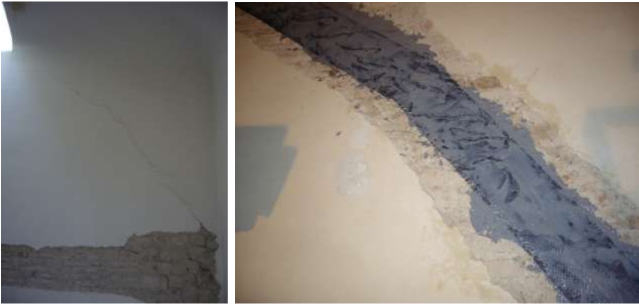
Stato fessurato di una parete in muratura ordinaria ed applicazione di materiali FRP per rinforzare la zona lesionata
