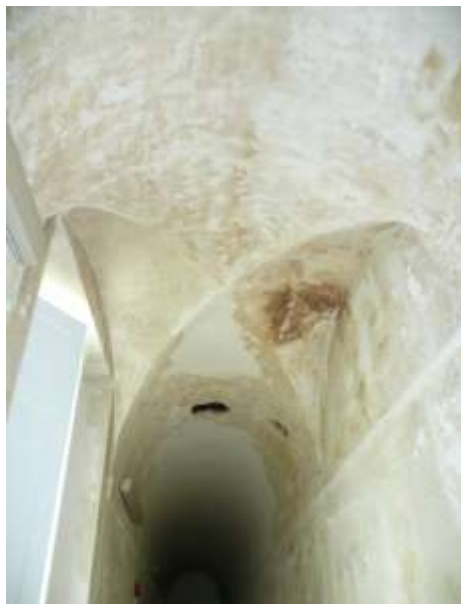
Controsoffitto esistente e deteriorato
