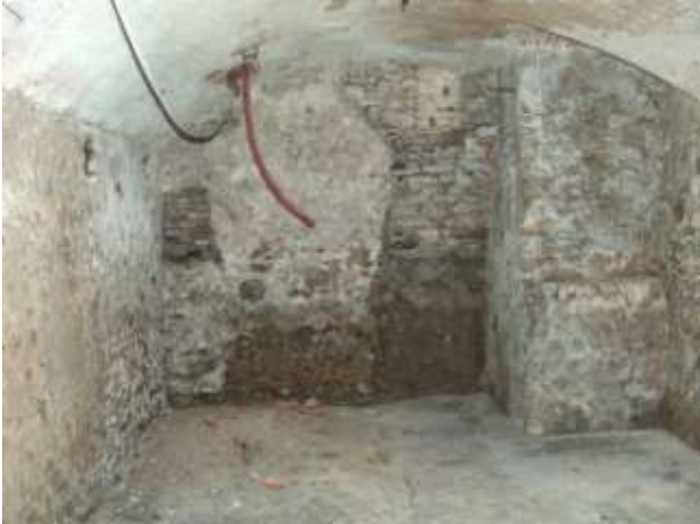
Stato di deterioramento di alcune murature esistenti
