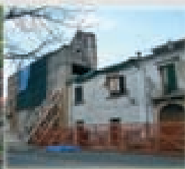
Area di San'Elia di Sant'Eusebio Fortissima, un insediamento di edifici in pietra, con mura di Chiosso di Sant'Eusebio.
