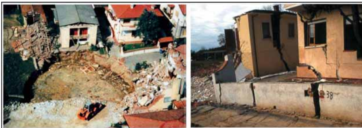
Figura 24 – Il sinkhole di Camaiore (LU) avvenuto nell'ottobre 2005 che ha causato il crollo di alcuni edifici (D'Amato Avanzi et al., 2004).
