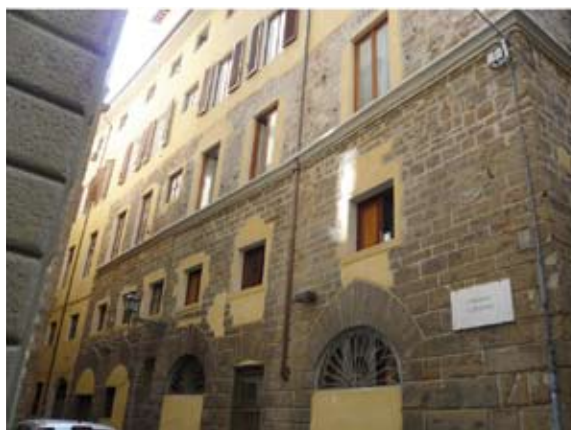
Le modifiche strutturali si presentano come tamponature murarie incongrue sottolineate da tinteggiature errate
