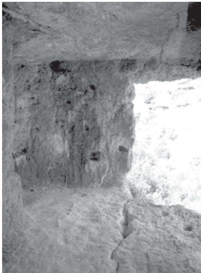
Fig. 3. Fratture beanti negli ambienti della Farmacia del Mago Greguro (PU/CA 827) a Massafra. Le fratture derivano da rilascio tensionale della parte più esterna della gravina, e si seguono con continuità all'interno di gran parte degli ambienti ipogei.
